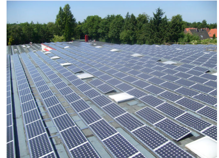
Großanlage auf Bitumen Flachdach
